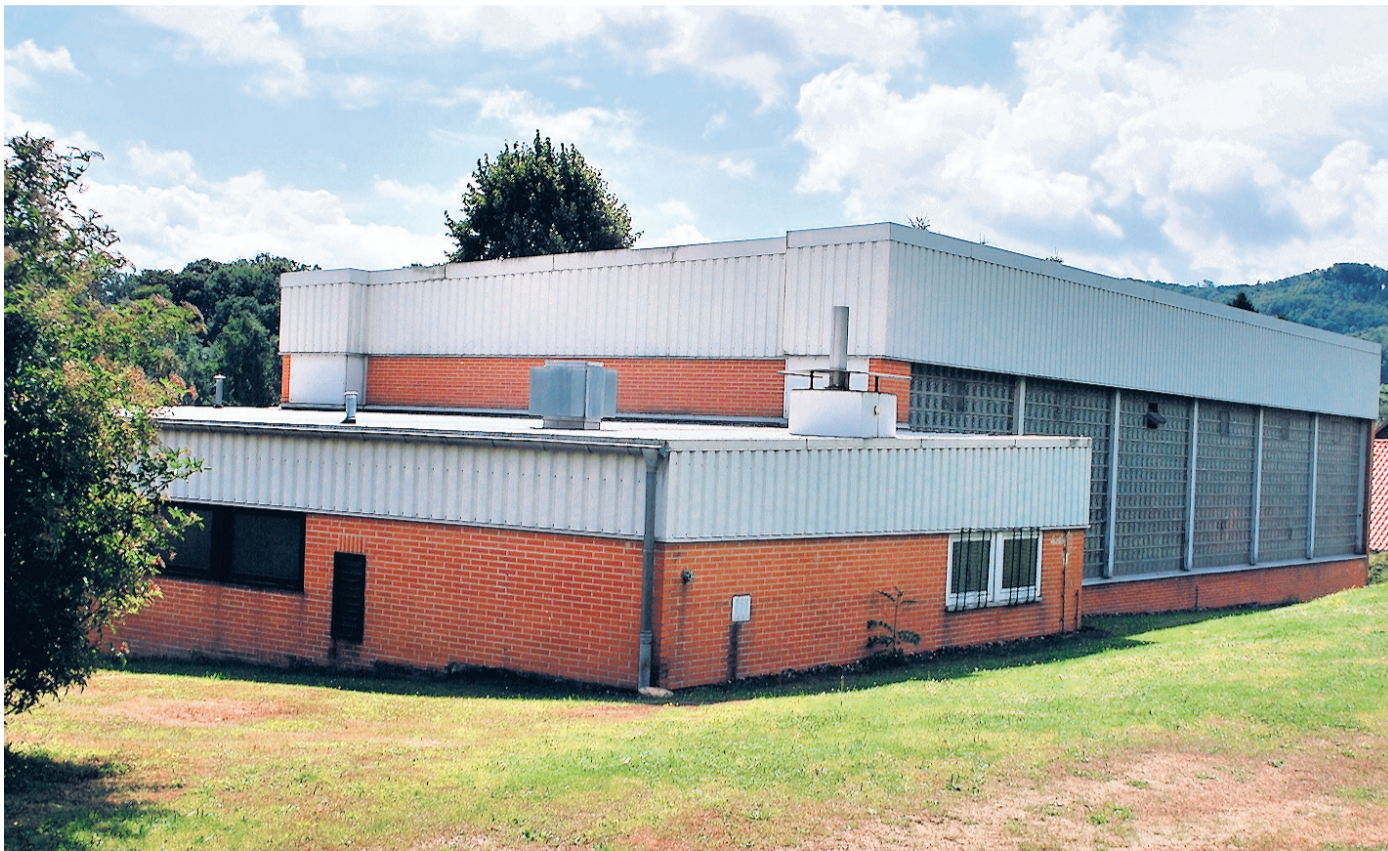
Die Sporthalle in Brunkensen wird in diesem Jahre 40 Jahre alt. Laut Bericht der Verwaltung kommt ein Bauunterhaltungsbedarf von 285 000 Euro zusammen. Unter anderem gilt die Glasbaufassade als energetisch problematisch. Foto: Stephanie Marschall
